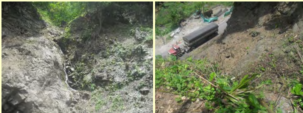
Figura 3 - 104. Sin Cobertura Vegetal – Quebrada NN Km 52
