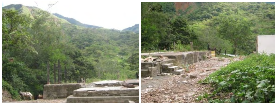
Figura 3 - 27. Sin Uso Centro de Acopio Vistahermosa
