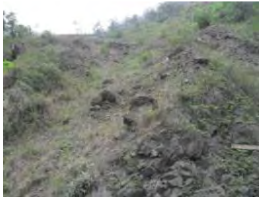
Figura 3 - 61. Pastos Enmalezados - Modificación Diseño Túnel 10 y Construcción de (2) Galerías de Evacuación - Margen Izquierdo.
