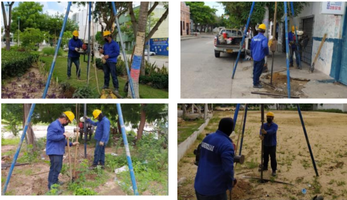
Fotografía 5.24 Sondeos mecánicos ejecutados en la Línea Subterránea a 110 kV S.E. Estadio – S.E. Centro
