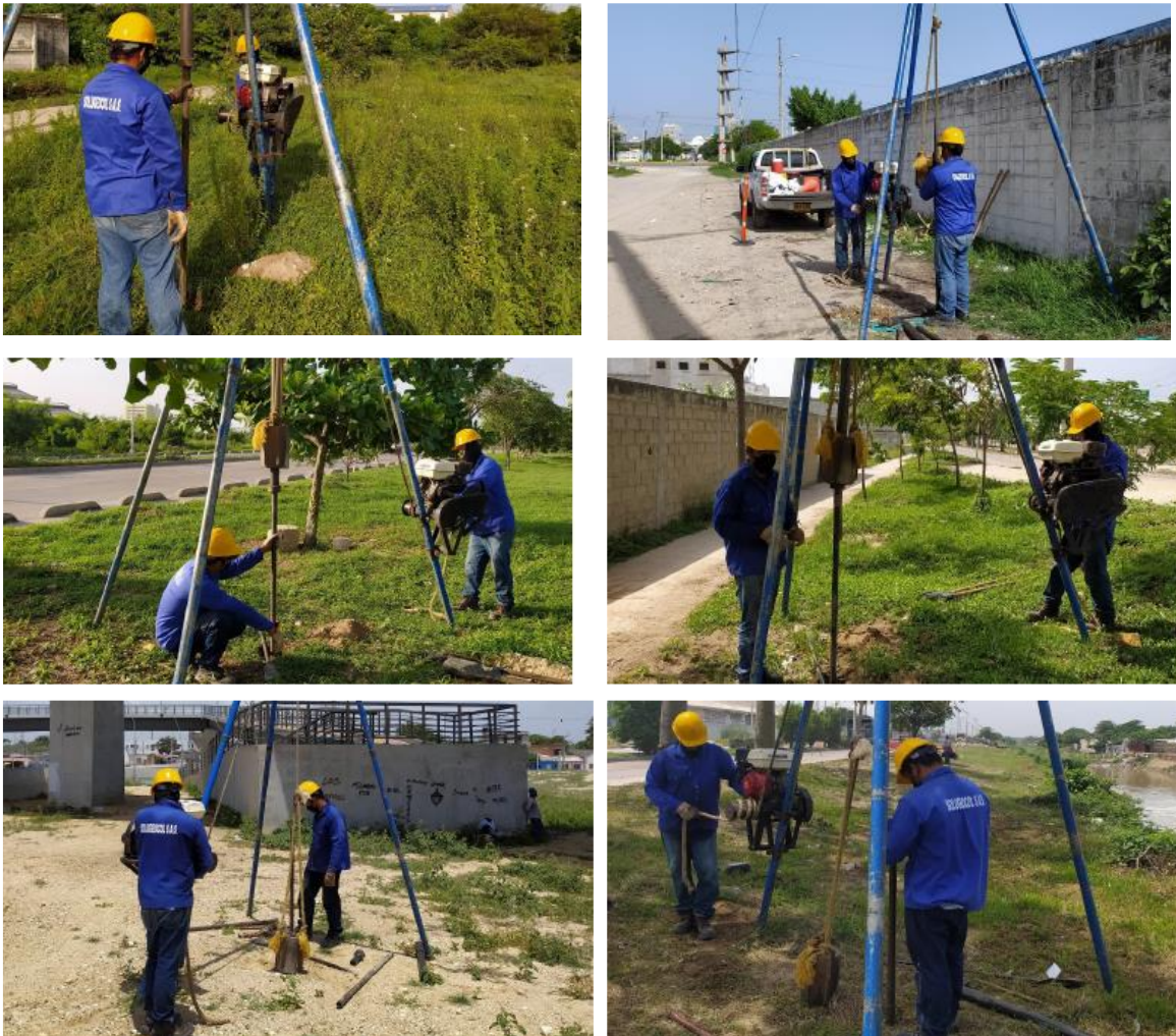
Fotografía 5.25 Sondeos mecánicos ejecutados en la Línea Subterránea a 110 kV S.E. Río – S.E. Magdalena
