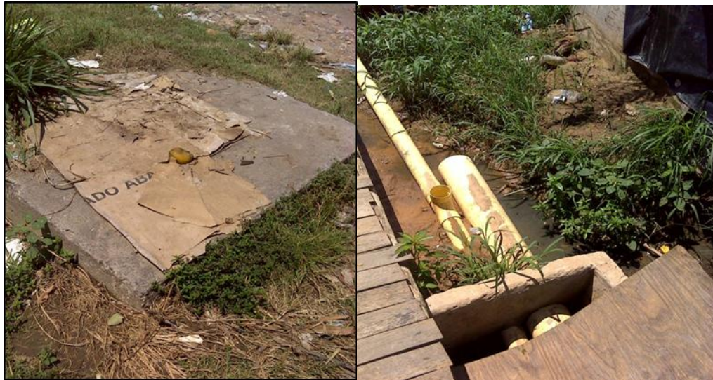
Fotografía 3-36 Pozo séptico de los barrios La Esperanza y Sapo Escondido
