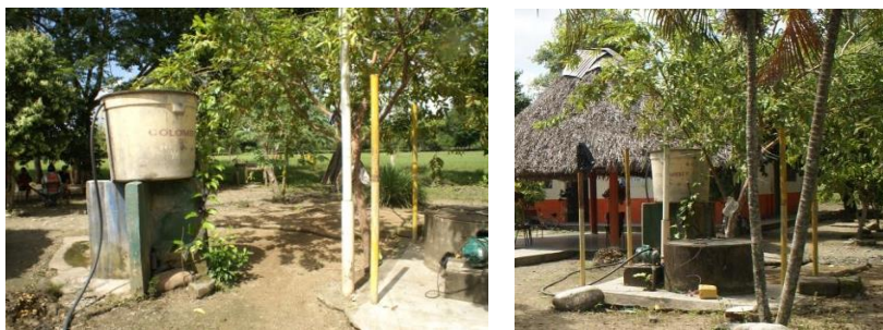
Fotografía 3.4.50 Pozo comunitario vereda Trapiche
