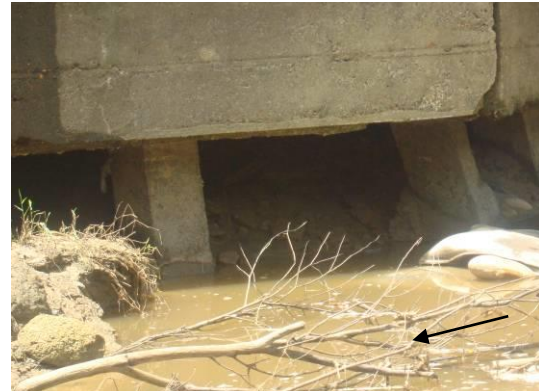
Socavación local – Estribo margen derecha
