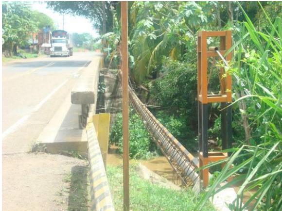
Tramo 2 - Ruta 4510 PR 93+0010 Tubería de 6" de TELECOM
