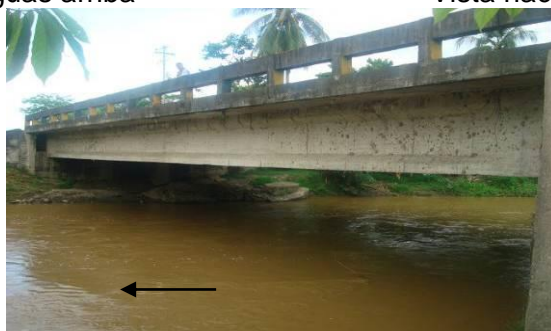
Sección del puente, luz de 31.0 m. Fotografía 3-35 Julio 28 de 2010 – Río San Alberto
