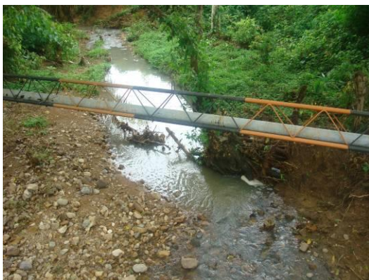
Tramo 7 - Ruta 4515 PR 34+0400 Tubería de 6" de TELECOM
