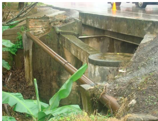
Tramo 7 - Ruta 4515 PR 42+0250 Tubería de 6" acueducto y colector embebido en concreto del alcantarillado
