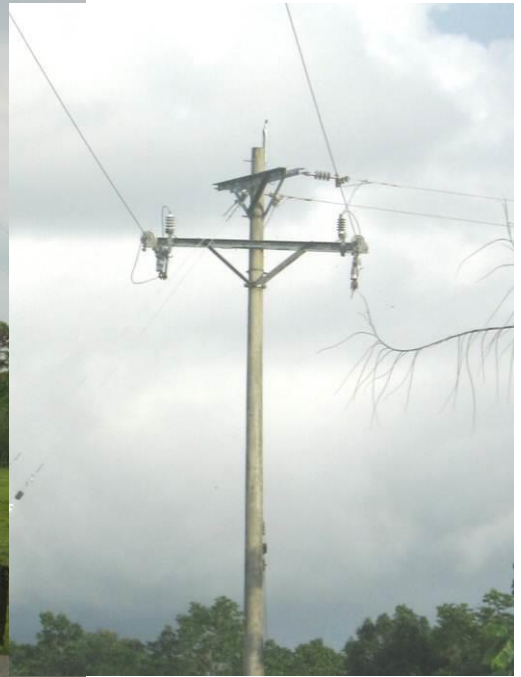
Fotografía 2-11 Red primaria a 13,2 kV, dos hilos, doble terminal
