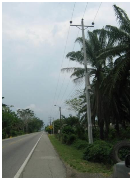
Fotografía 2-6 Red primaria a 13,2 kV, tres hilos, suspensión
