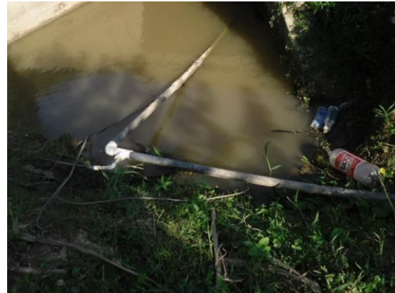
Fotografía 2-4 Derivación en cruce de la red de acueducto
