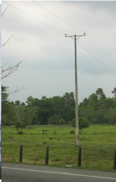
Fotografía 2-10 Red primaria a 13,2 kV, dos hilos, suspensión
