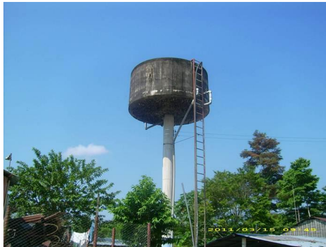
Fotografía 2-5 Tanque en operación 20 de Julio
