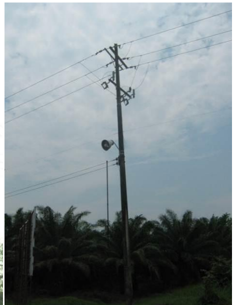
Fotografía 2-14 Red primaria a 13,2 kV, tres hilos con aisladero y pararrayos
