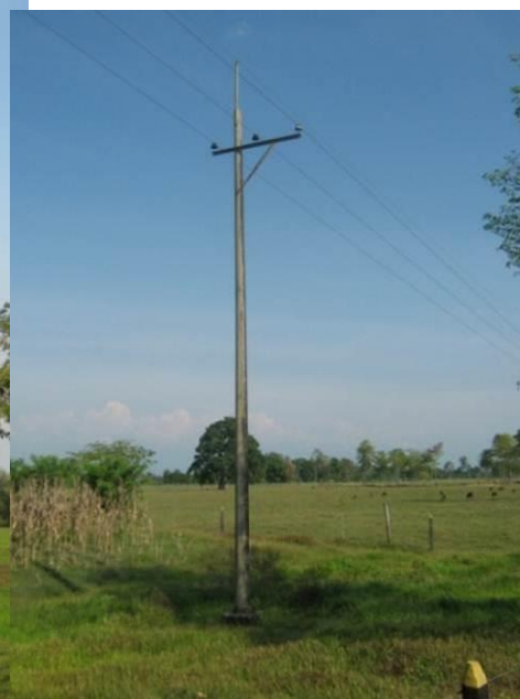
Fotografía 2-8 Red primaria a 13,2 kV, cuatro hilos, suspensión
