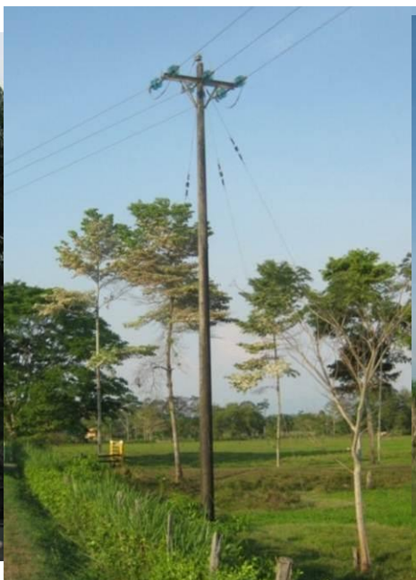
Fotografía 2-7 Red primaria a 13,2 kV, tres hilos, retención
