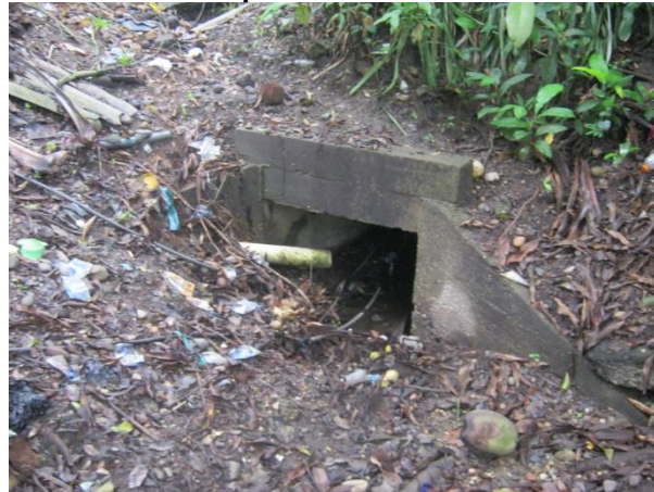
Fotografía 3-4 Contaminación por vertimiento de aguas residuales e inadecuada disposición de residuos sólidos
