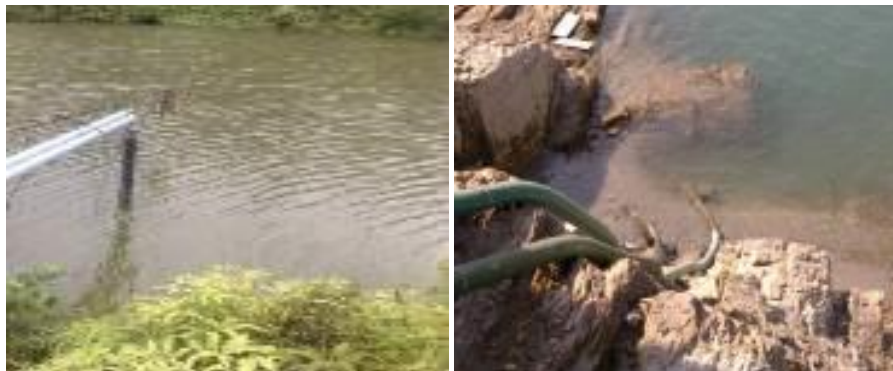
Fotografía 4-2 Sistema de captación de aguas.
