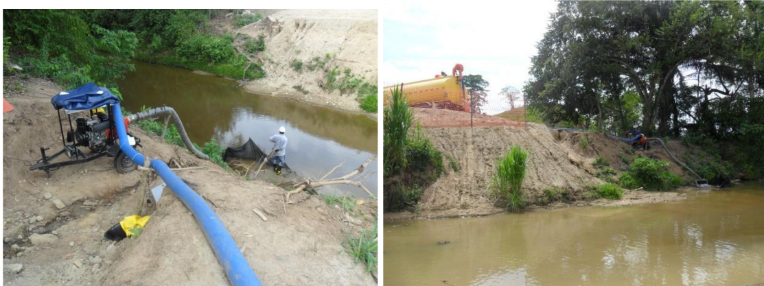
fotografía 4-1 Sistema de captación de aguas
