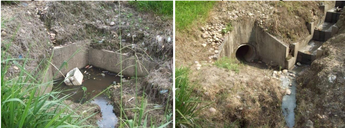
Fotografía 3-47 Obras de drenaje de la vía actual con presencia de aguas servidas.
