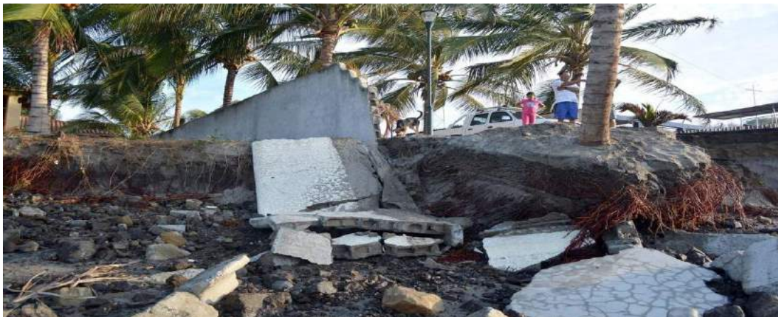
Figura 4-28. JAMA, Manabí. Una pared cayó en el sector por el fuerte oleaje.
