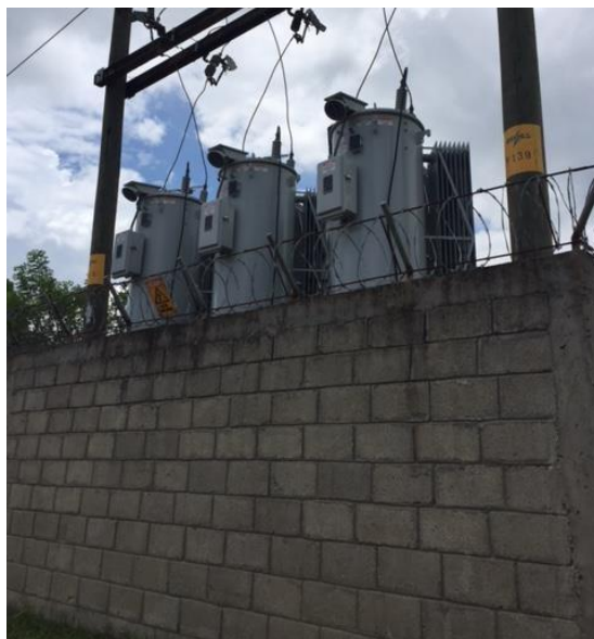
Foto 6 Transformador de energía del CH Mezapa ubicado en el Caserío El Retiro
