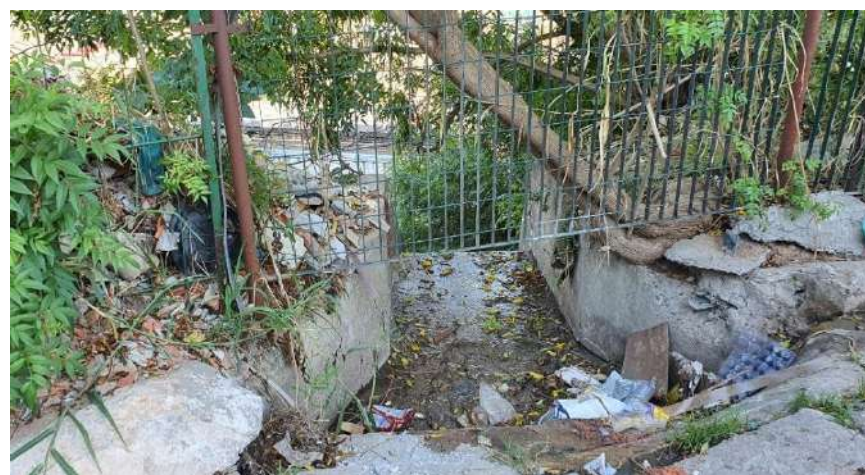
Foto 4.2.3-2: Detalhe do início da escada hidráulica. À esquerda, depósito de entulhos, cujo lançamento foi restringido devido ao cercamento com gradis pela Prefeitura. (Ecodue, 2020).
