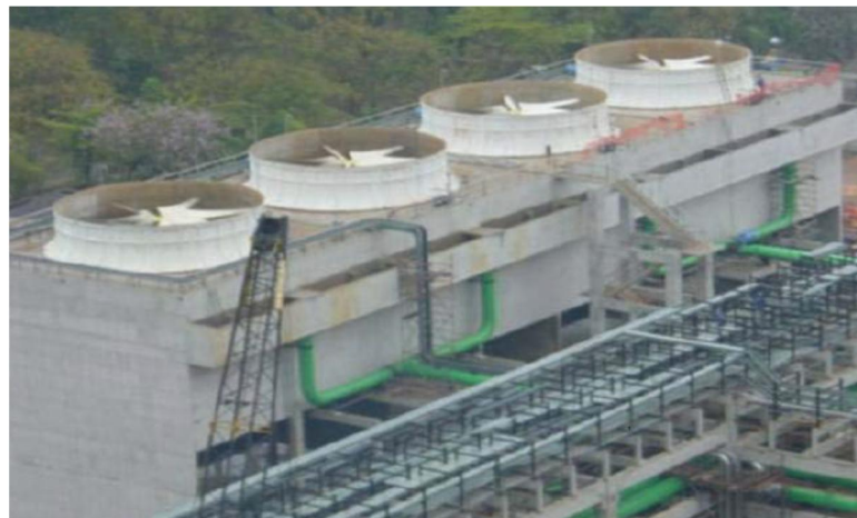
Figura 23 – Torres de Resfriamento. Fonte: Poyry, 2018.
