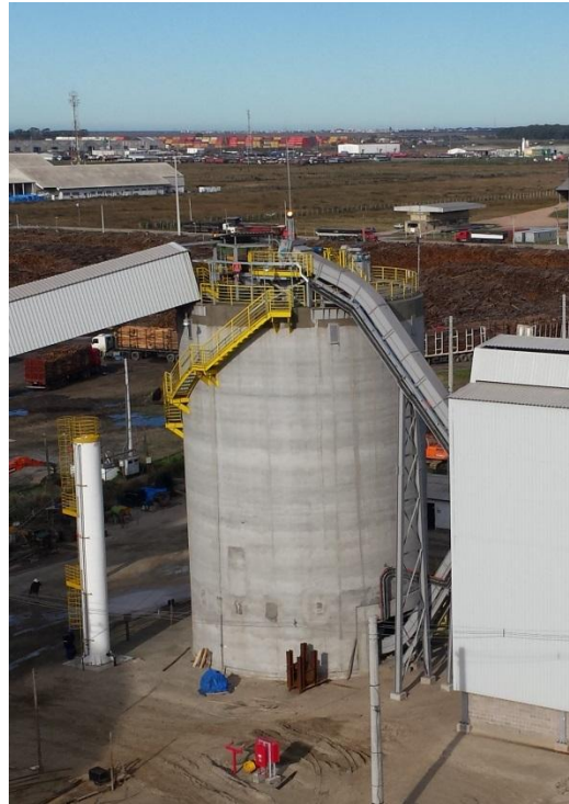
Figura 19 – Silo de cavacos. Fonte: Pöyry, 2018.
