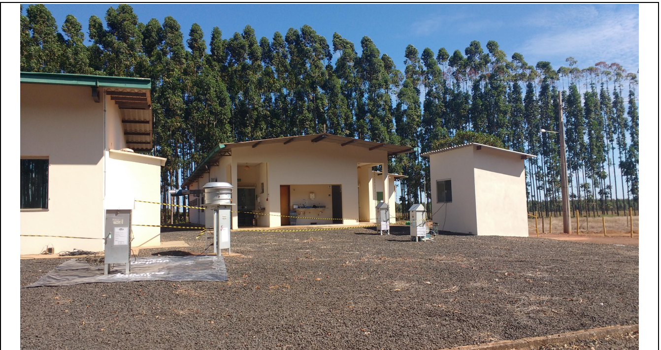
Figura 3 – Visão geral inversa dos equipamentos no ponto de amostragem.
