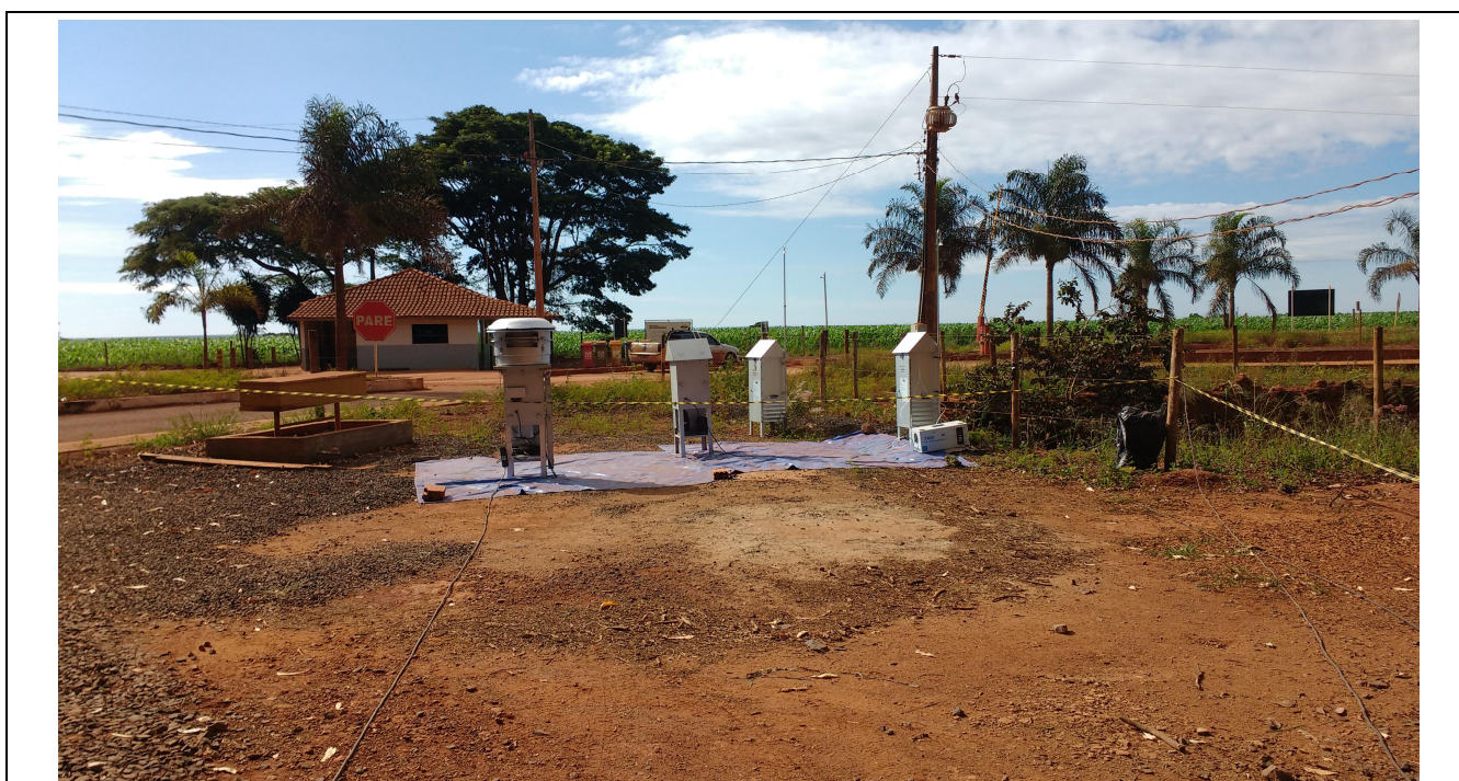
Figura 2 – Visão geral inversa dos equipamentos no ponto de amostragem.
