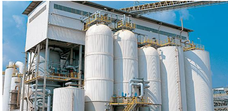
Figura 6 – Planta de cozimento dos cavacos de madeira. Fonte: Pöyry, 2018.
