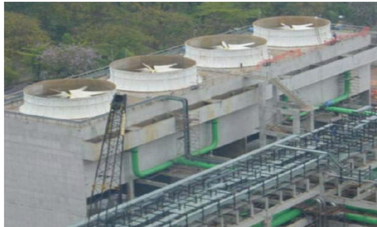
Figura 8 – Torres de Resfriamento. Fonte: Pöyry, 2018.
