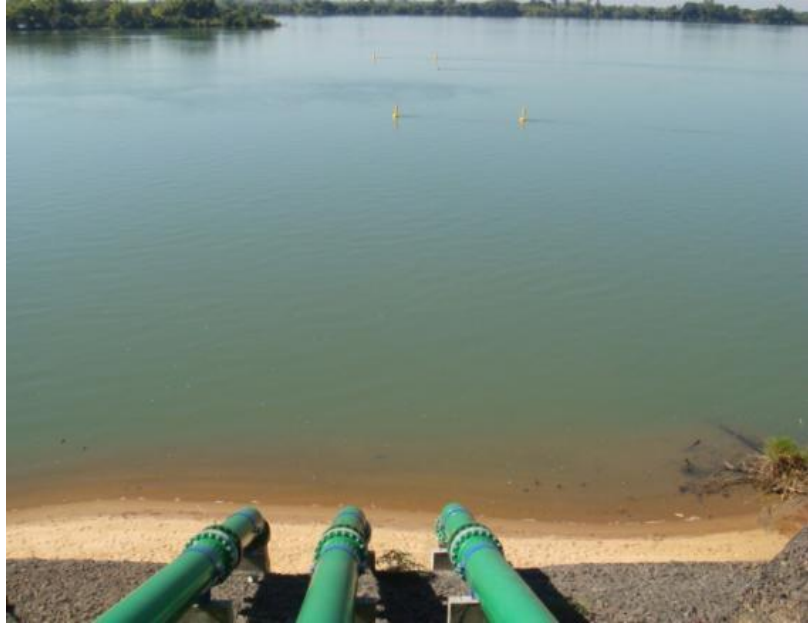
Figura 10 – Emissário de Efluentes. Fonte: Pöyry, 2018.
