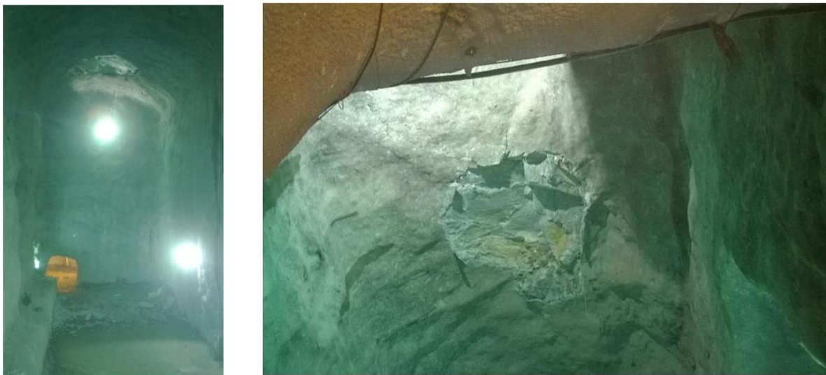
Figure No.15: Desprendiment bòveda Casa de Maquinas – Costado norte
