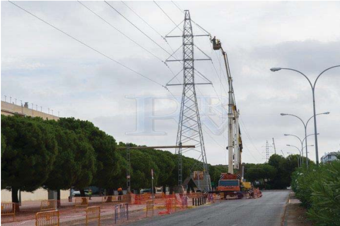
Ilustración 7: UTILIZACION DE GRUAS DE TAMAÑO ADECUADO AL AREA DE ACCESO SON UTILIZADAS EN LA ACTIVIDAD DE TENDIDO Y TENSADO.
