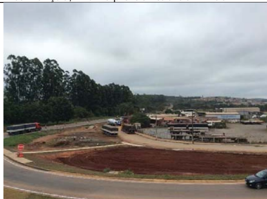
Visada 51S: Km 372+800. Vista da ADA ITV 158 que está em andamento, município de Itaú de Minas.
