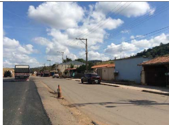
Visada 10S: km 74+000. Vista da ADA ITV 14 a 22, que se encontra em obras, município de Mateus Leme.
