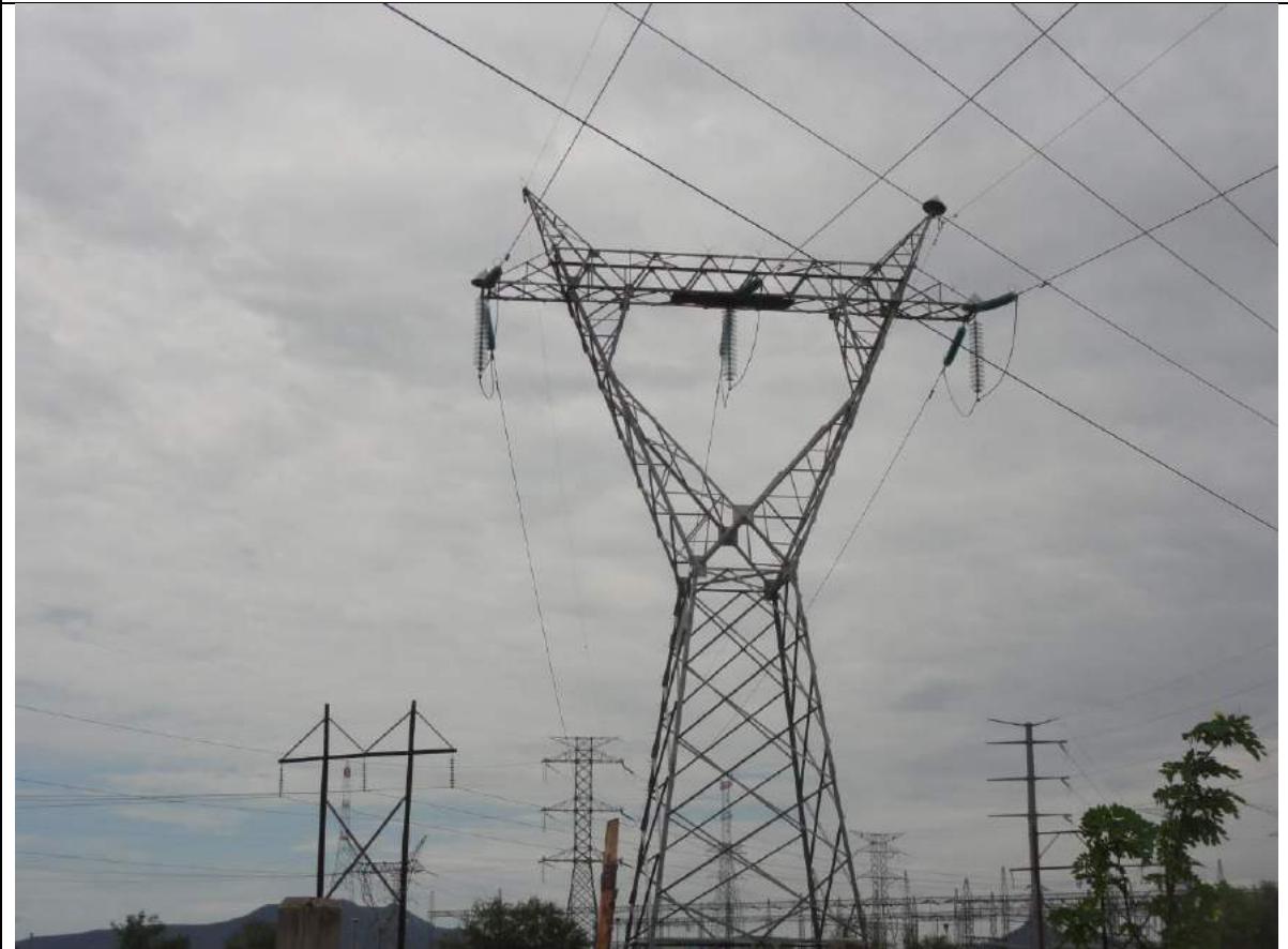
Al fondo Sub estación Pueblo Nuevo de CFE
