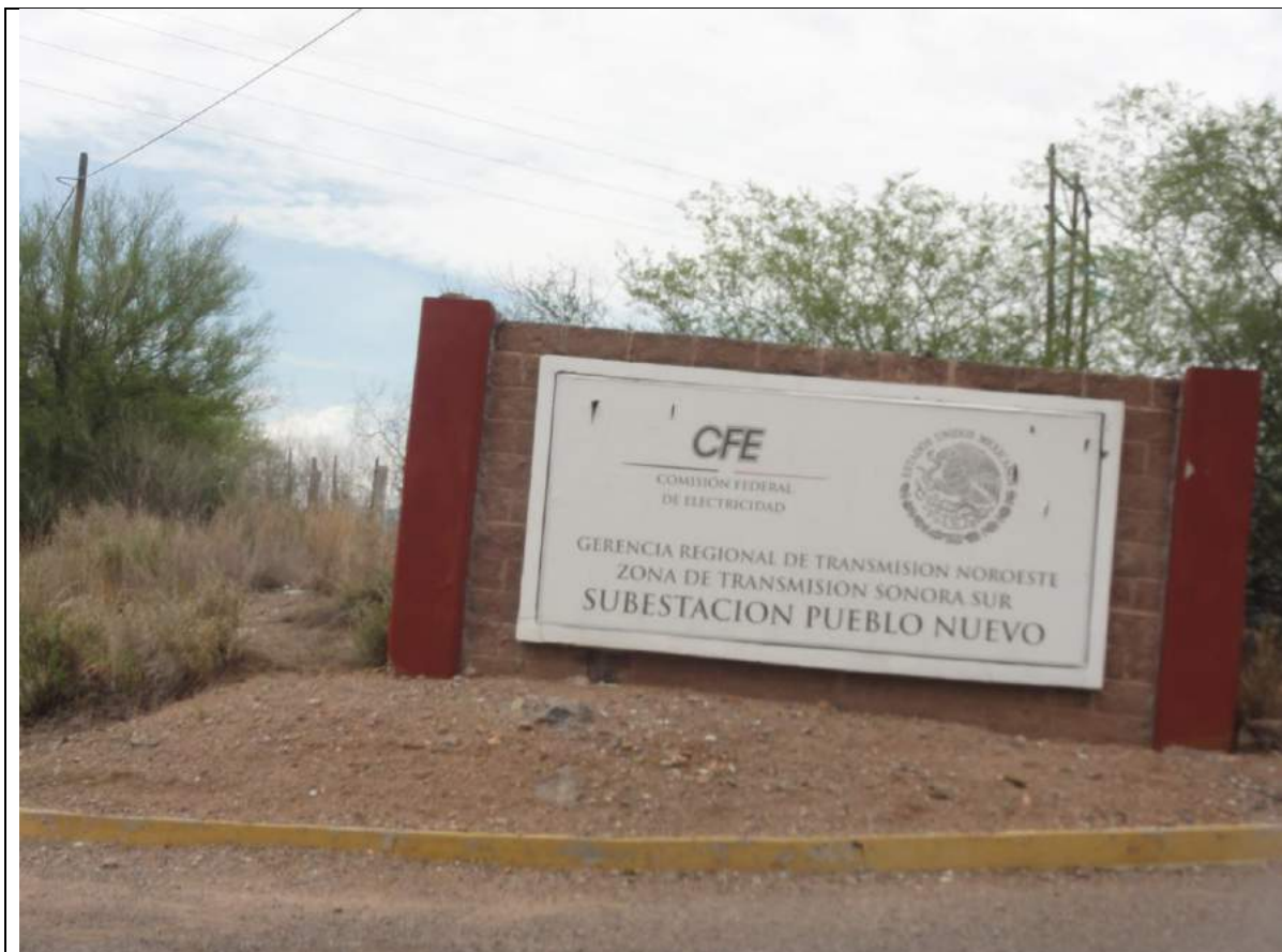
Sub estación de interconexion
