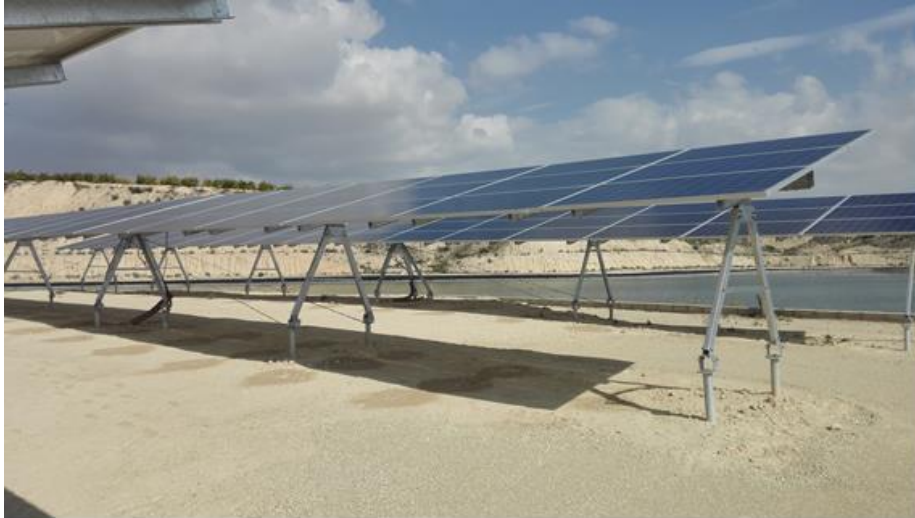
Figura 16. Painéis fotovoltaicos com seguidores.
