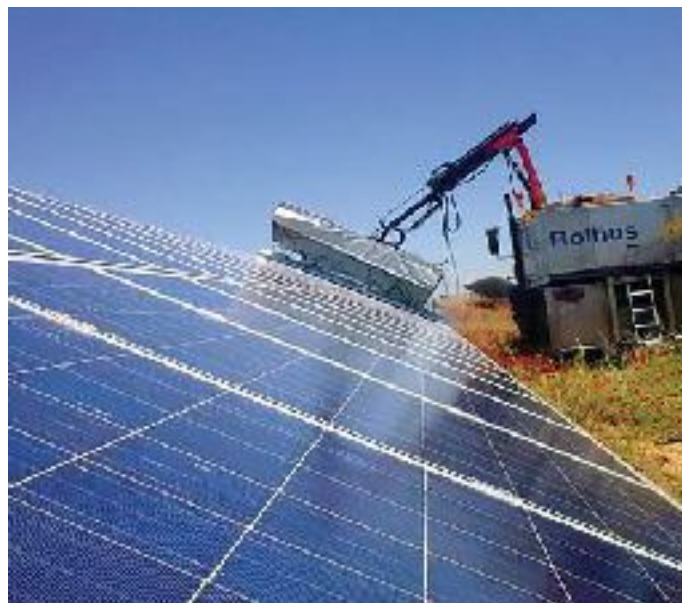
Figura 2.19 Sistema semiautomático de limpieza de los módulos fotovoltaicos.
