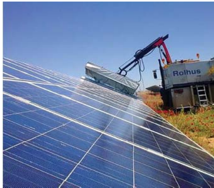
Figura 2.19 Sistema semiautomático de limpieza de los módulos fotovoltaicos.
