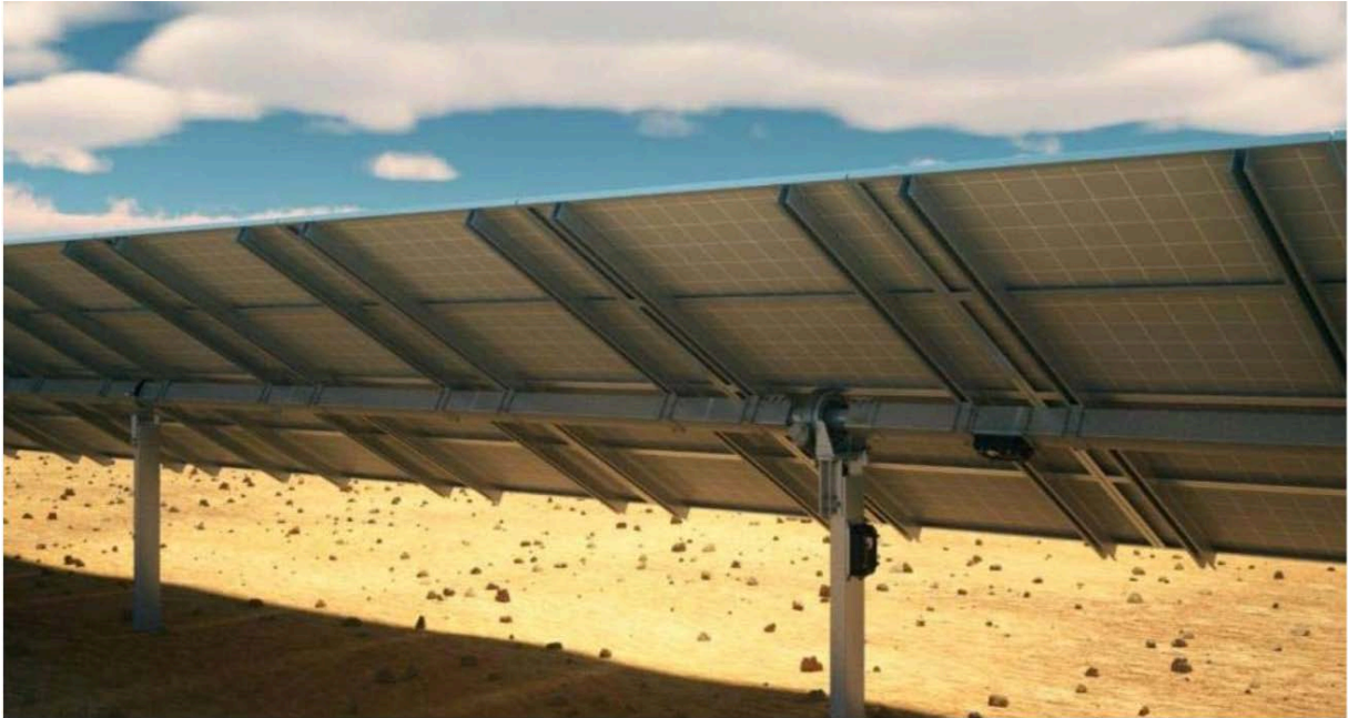
Figura 2.28 Módulos fotovoltaicos instalados sobre las estructuras soporte, constituyendo un seguidor (tracker) de módulos fotovoltaicos.
