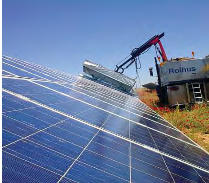
Figura 2.30 Sistema semiautomático de limpieza de los módulos fotovoltaicos.
