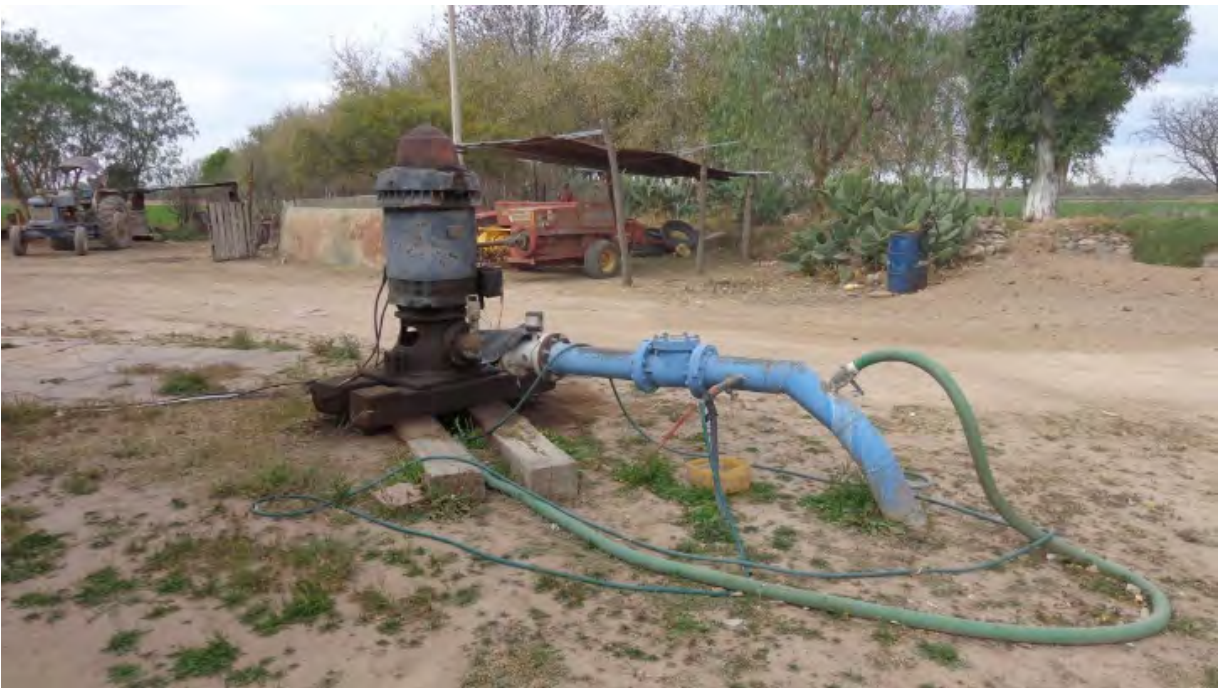
Figura 4.34. El pozo profundo ubicado en Rancho Nuevo.
