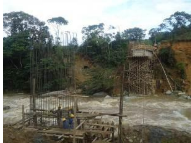
Foto 3-65. Construcción del nuevo puente sobre el Cocorná en la vereda La Inmaculada, por parte del proyecto hidroeléctrico El Popal.
