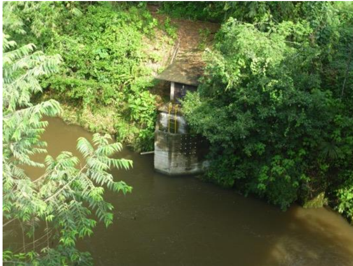
Fotografía 5.1.12-1 Fecha: 2017/03/02 Fotografía: Mark Thurber Descripción: Toma de agua para la planta extractora La Sexta en el río Sábalo al lado de proyecto.
