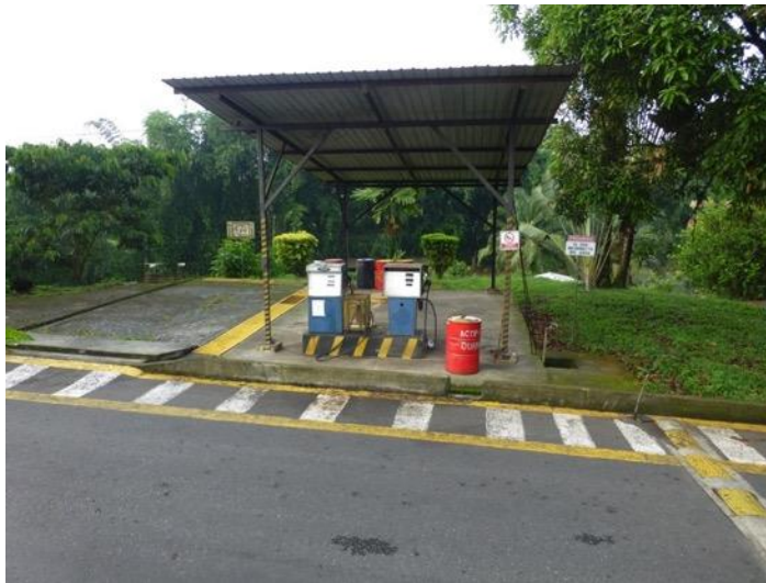
Fotografía 5.1.6-6 Fecha: 2017/03/02 Fotografía: Mark Thurber Descripción: Tanques de almacenamiento subterráneo para diesel y gasolina en la planta extractora La Sexta, ubicados en una colina sobre el área de proyecto.
