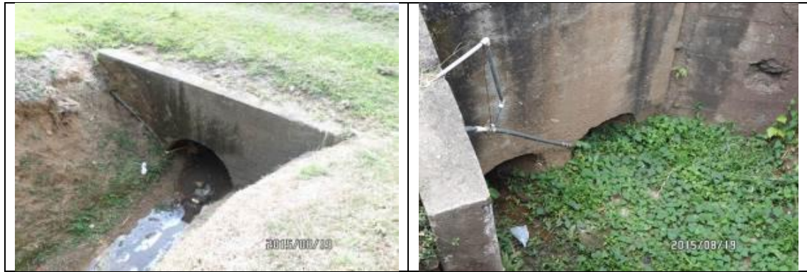
Fotografía 9 Obras con colmatación < 50%
