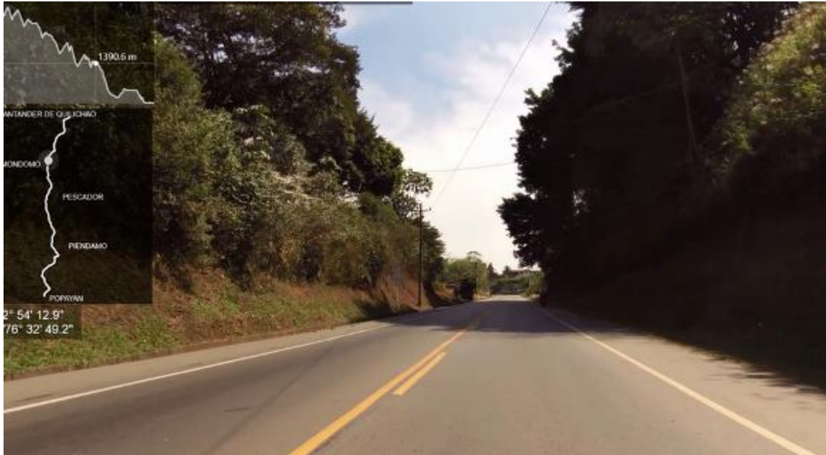
Fotografía 1 Estado pavimento Unidad Funcional 4 (Sector K68+860 al K76+091)
