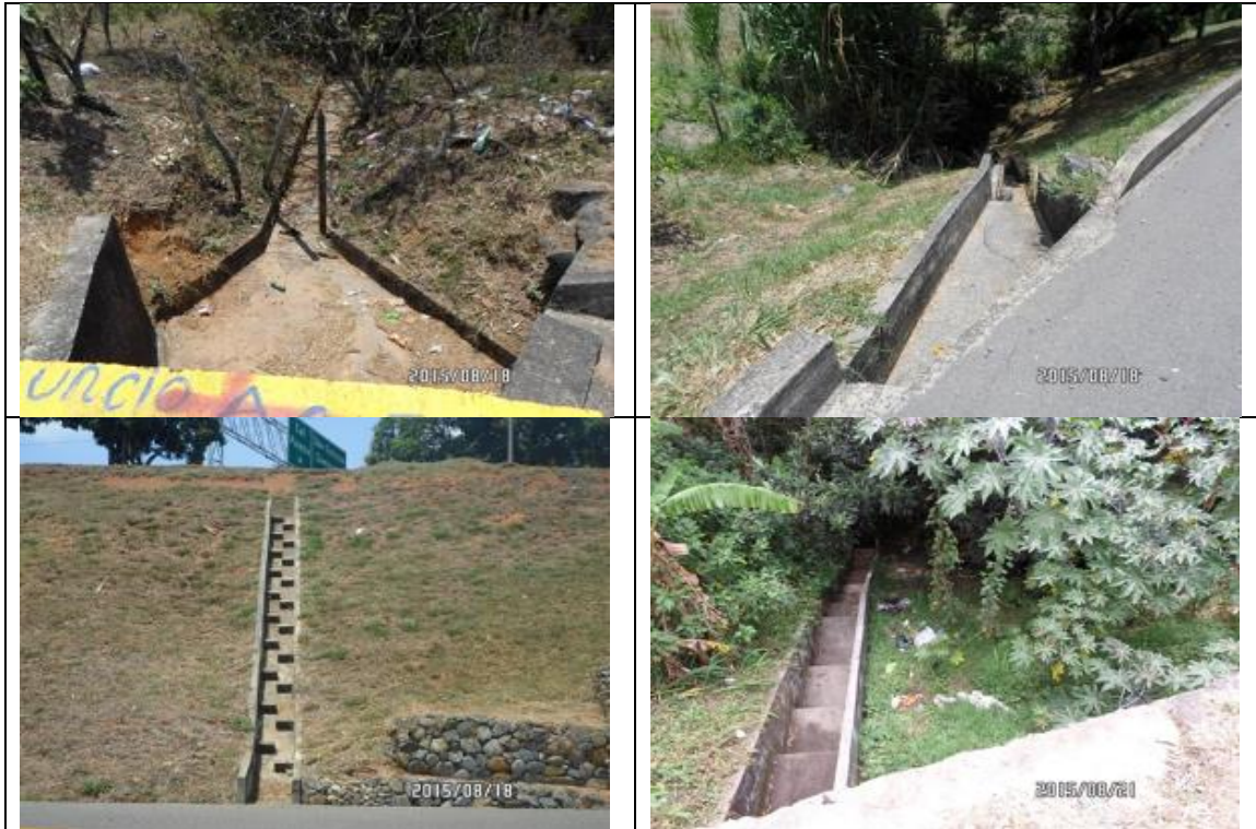
Fotografía 11 Canales y disipadores de energía existentes
