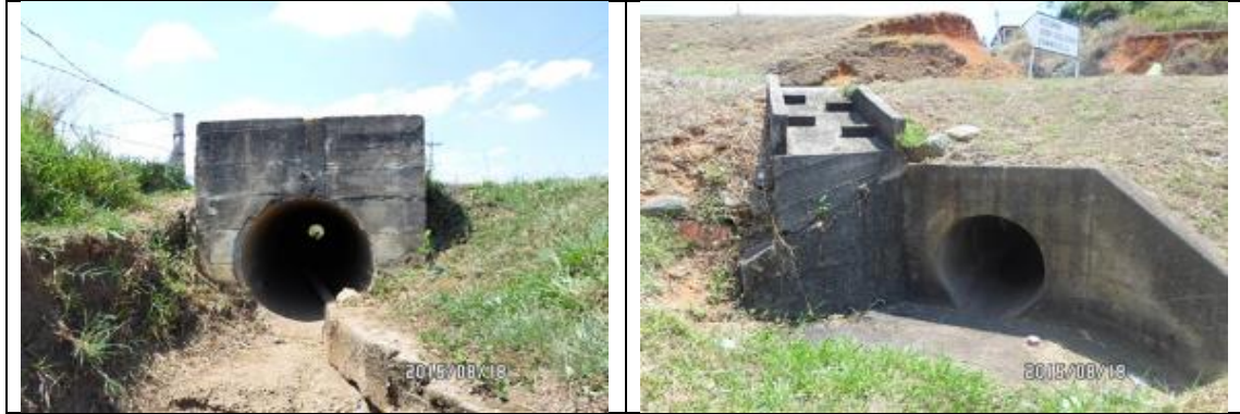
Fotografía 8 Obras con colmatación 0%
