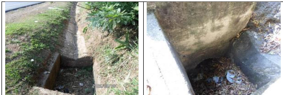
Fotografía 10 Obras con colmatación > 50%
