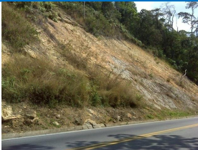
Fotografía 5–14 Superficie estructural de la Formación Tablazo, talud de la vía muy cerca restaurante Brisas
