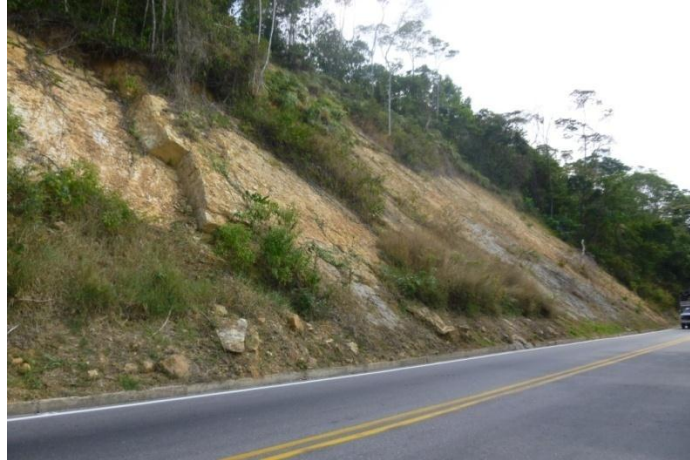
Fotografía 5–34 Sector de la vía existente, con deslizamientos planares
