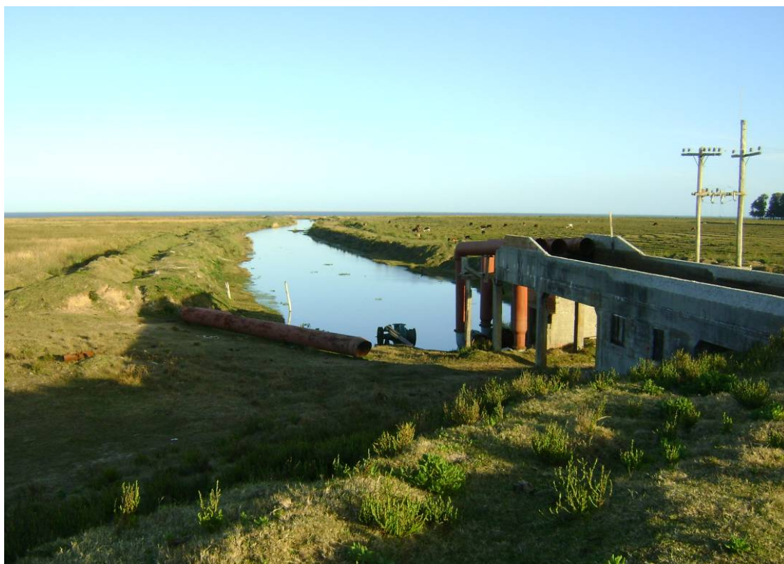
Figura 6.2.7 - Ponto de bombeamento de água nas proximidades da Lagoa Mangueira.
