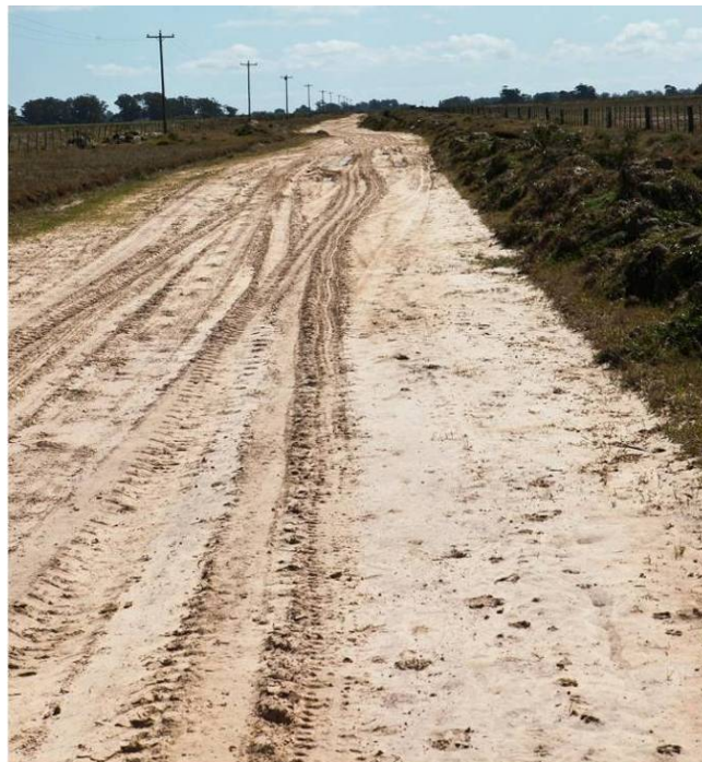
Figura 5.5.8 - Exposição de solo arenoso em leito de via de acesso local situada no ponto de coordenadas UTM (Datum SAD69) x=319741 , y=6326884 .
