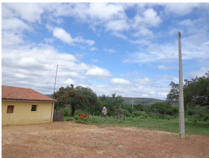
Foto 6.118 – Vista do sistema de eletrificação da localidade de Mimoso.
