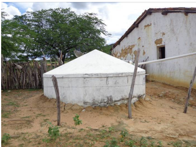
Foto 6.77 – Cisterna instalada em uma residência da localidade de Cacimba do Mato.
