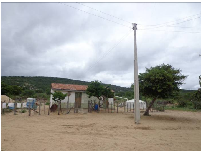
Foto 6.93 – Rede elétrica que abastece as residências da localidade de Manguinha, não há iluminação pública.
