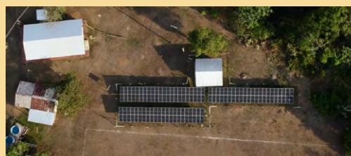
Crédito: UCB Documental “Energía que transforma vidas”
