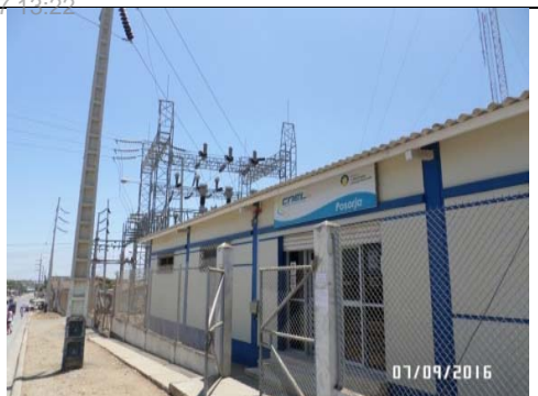
Foto 20: Sub Estación de la Empresa Eléctrica - Parroquia Posorja Fecha: 08/09/2016 Fuente: Cardno
